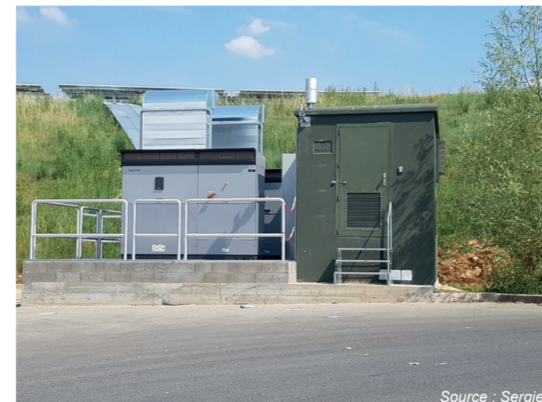
Poste de transformation (image de référence)
